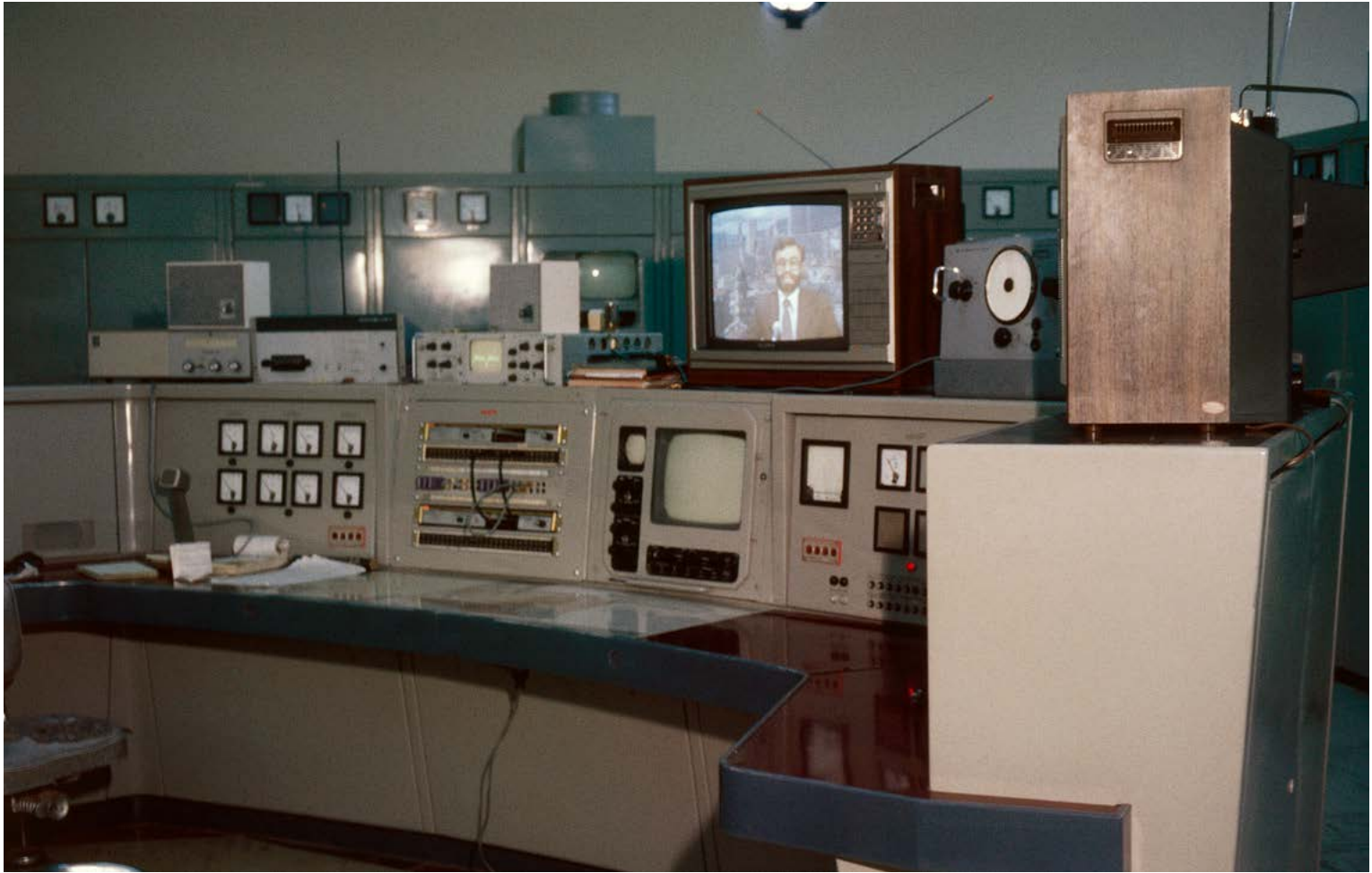
En las alturas. Interior de la estación principal de transmisión de radio y televisión en Facatativá (Cundinamarca), ubicada a una altura de 3200 m s. n. m. en el cerro de Manjuy. c. 1985 - Jairo Escobar.
