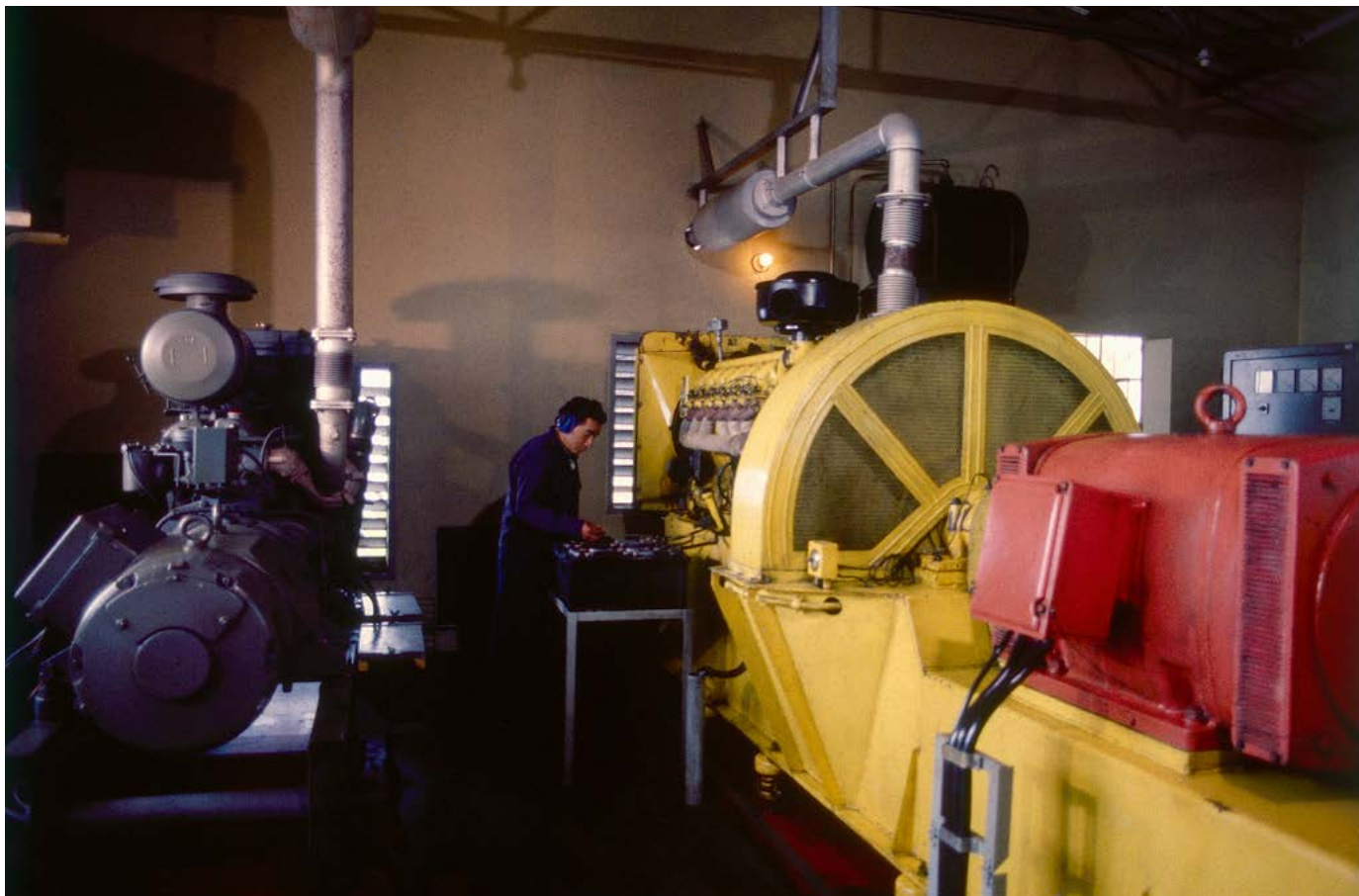
¡Electrizado! Técnico operando una planta de energía necesaria para el funcionamiento de las estaciones de transmisión televisiva en regiones sin suministro eléctrico público. c. 1982 - Jairo Escobar.
