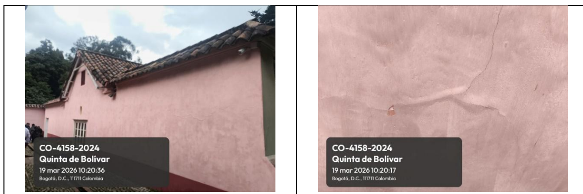
Imágenes 1 Pintura con deterioro prematuro
