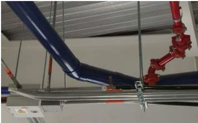
“Fotografía 1. Punto de Suministro Zona Cocina de Restaurante, 3er piso”
