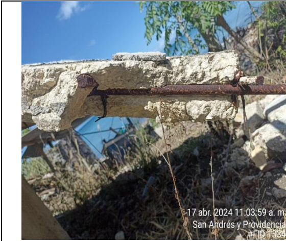
Fotografía 3. Corte longitudinal de la placa de la rampa de acceso
